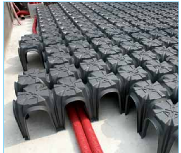
fig. 4) Installation du système MODULO FREEZE
