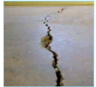
fig. 3) Dommage provoqué par cryoturbation.
