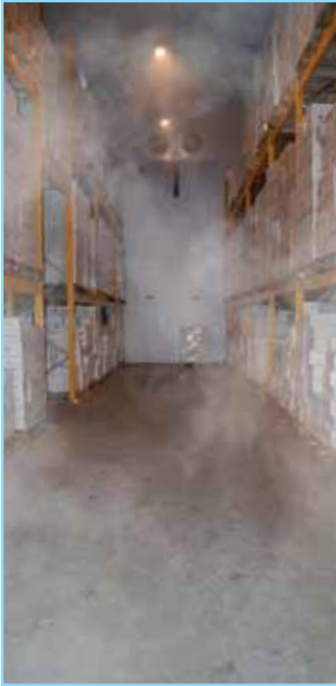
fig. 1) Intérieur d'une cellule frigorifique.
